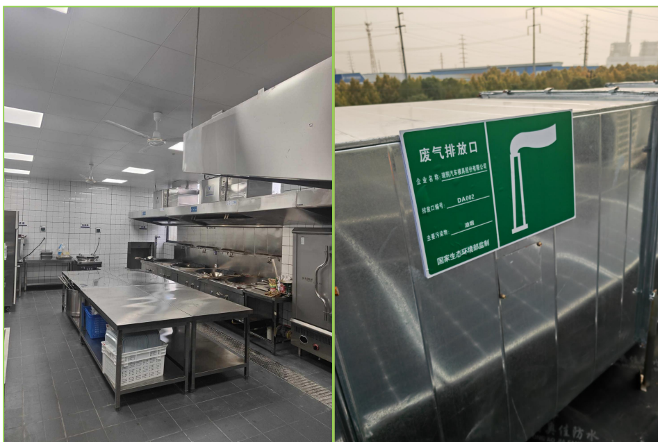
图 3-1 食堂油烟油烟管道
