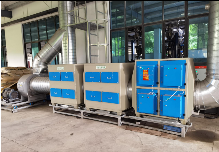
挤出废气处理设置（1 套等离子废气净化器+二级活性炭吸附装置）
