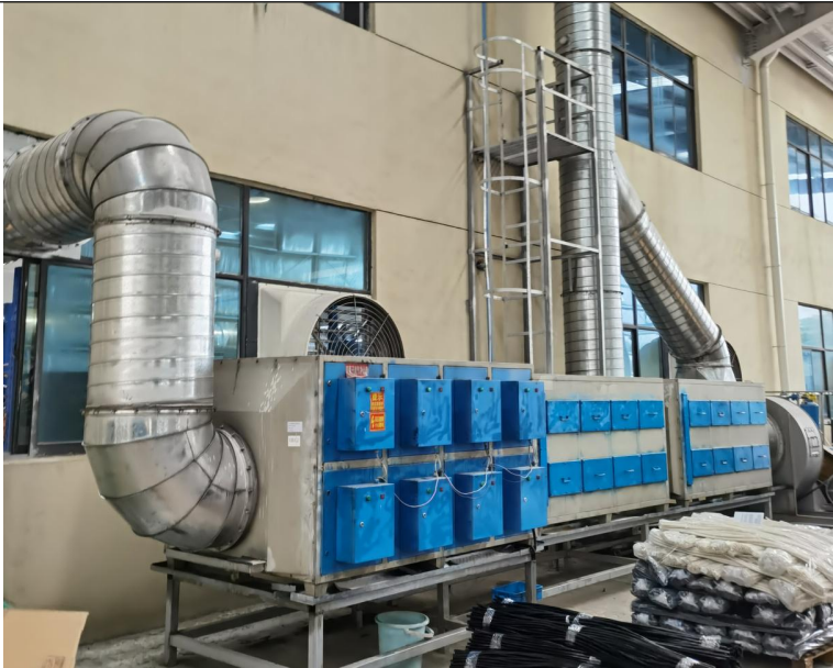
预热、成型废气处理设置（1 套等离子废气净化器+二级活性炭吸附装置）
