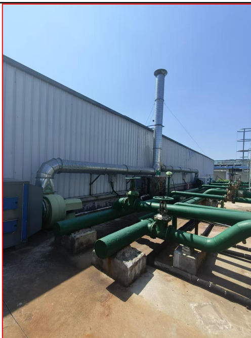
图 3-1 吹塑机组以及废气处理设施
