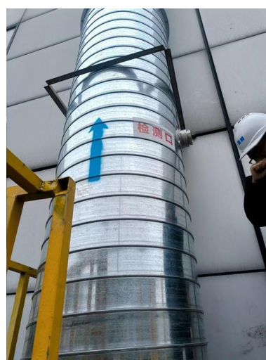
DA001 废气采样口
